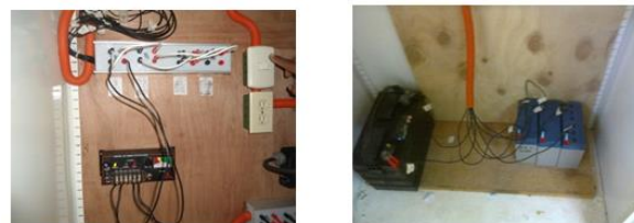
Figura 3 Instalación de las polaridades de cada módulo, el control de voltaje y los acumuladores de almacenamiento.
