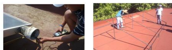
Figura 3 Salida del aire de los colectores solares e inclinación al sur.
